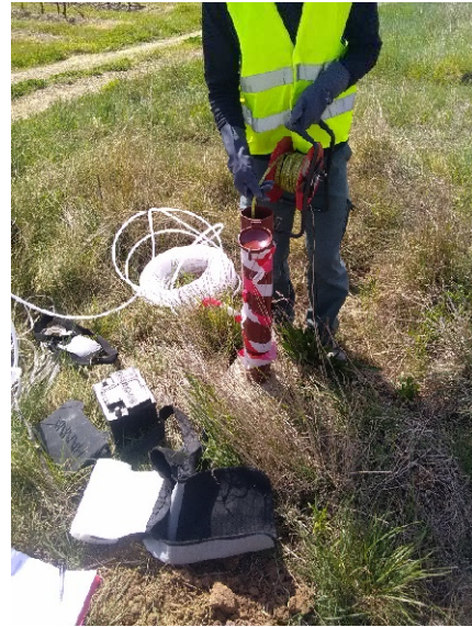
Piézomètre SC5 (position aval)
