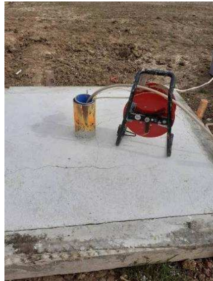
Piézomètre SC1 (position aval)
